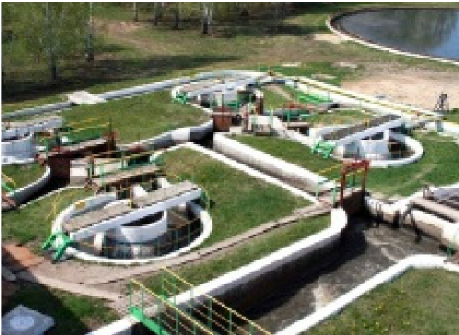
Общий вид современных водоочистных сооружений
